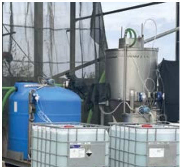
Planta piloto de tratamiento para la precipitación de estruvita a partir de digestato
