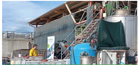
Planta pilot de tractament d'estruvita recuperada del digestat
